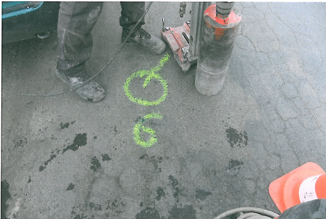
Fot . 40. Lokalizacja odkrytki Nr 6 w km 0+700, pas lewy
