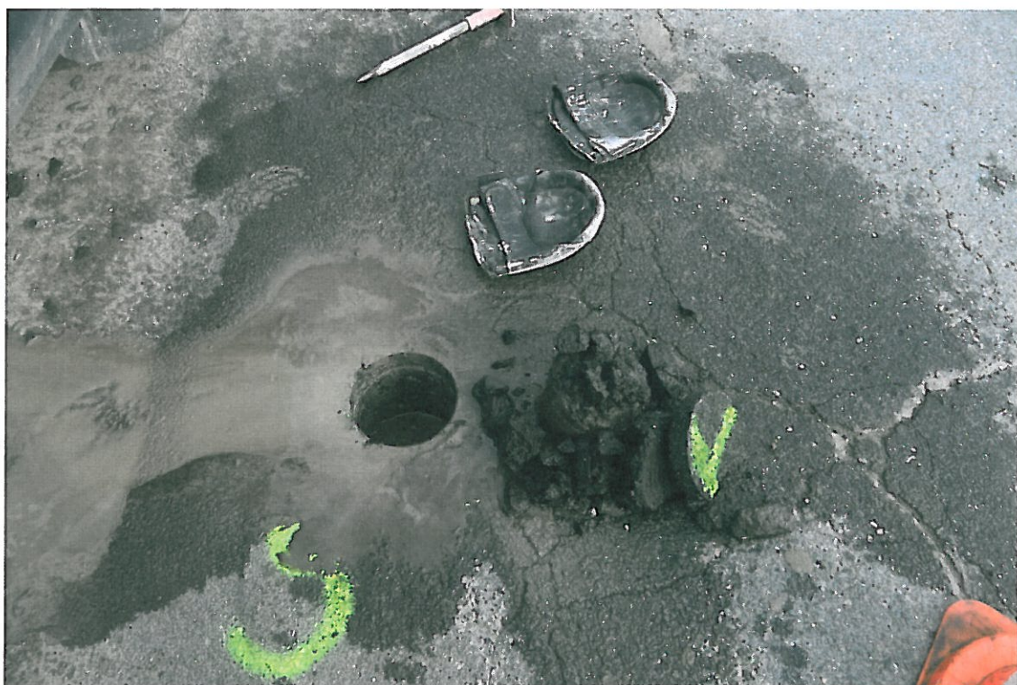
Fot . 52. Widok odwiertu z mas bitumicznych w Nr 9 w km 1+700, pas lewy
