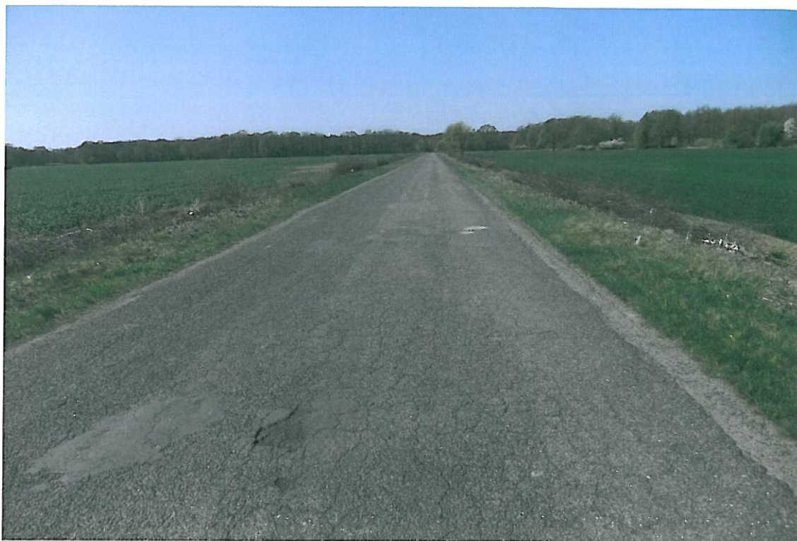
Fot . 89. Widok spękań odcinka drogi Lenartowice - Księginice, km 5+900.
