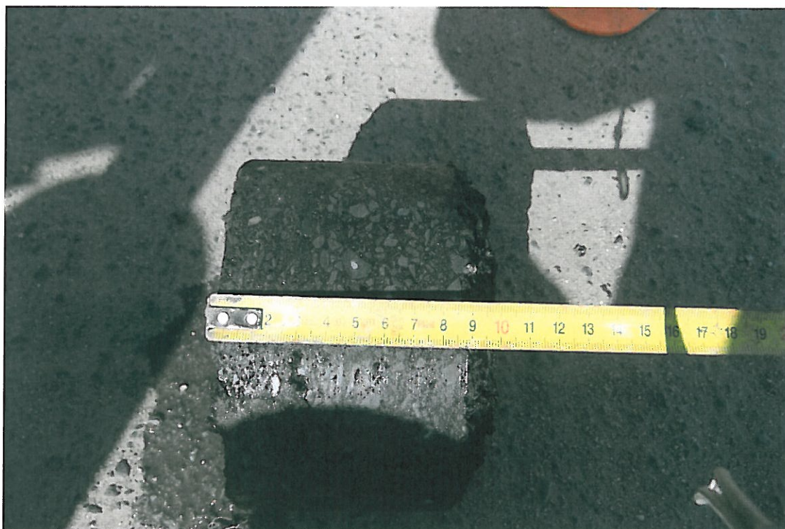
Fot . 33. Widok próbki z warstw bitumicznych i bruku odkrywki Nr 4 w km 0+000
