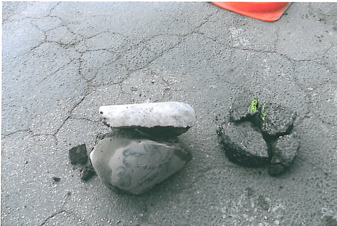
Fot . 45. Widok próbki z warstw bitumicznych i bruku odkrywki Nr 7 w km 1+000
