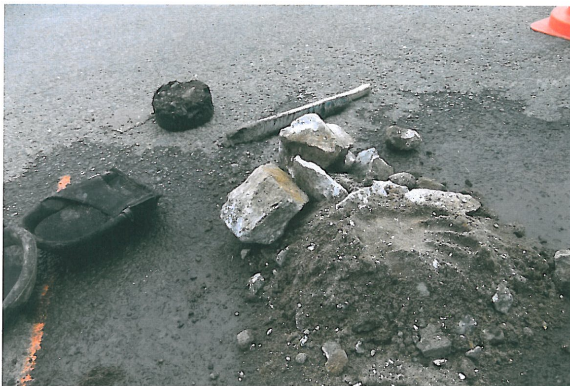
Fot . 82. Widok próbki kruszywa z podbudowy, odwiertu Nr 16 w km 4+300, pas prawy
