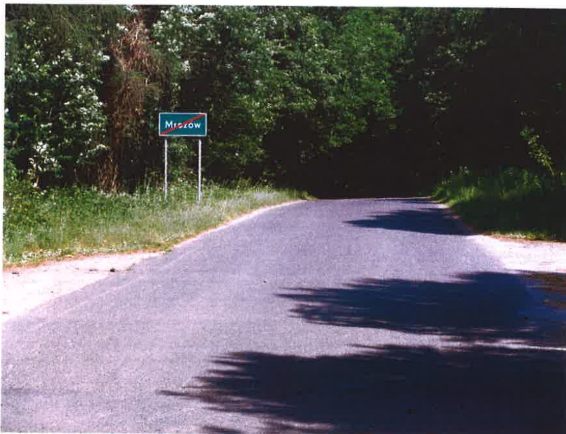
Fot . 7. Stan nawierzchni drogi na granicy miejscowości Mrozów ( 0+750 )
