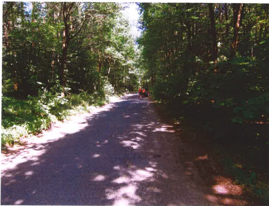
Fot. 8. Spękania nawierzchni drogi w rejonie km 0+800
