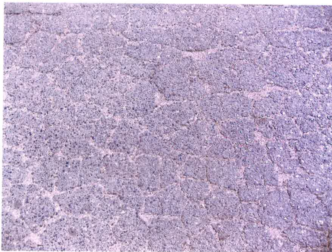
Fot . 3. Widok spękań nawierzchni w rejonie km 0+400
