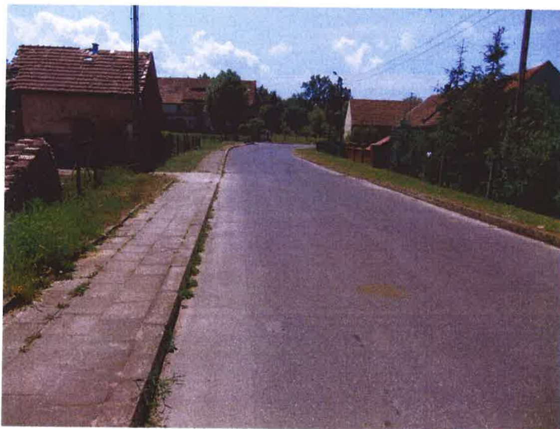
Fot. 11. Widok nawierzchni drogi w Wojnowicach, km 1 + 700
