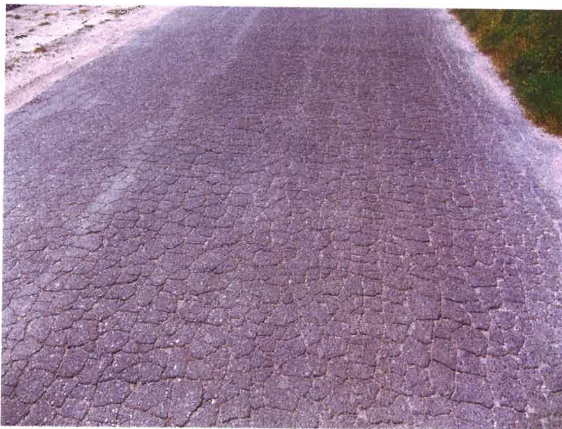
Fot . 6. Stan nawierzchni drogi w miejscowości Mrozów
