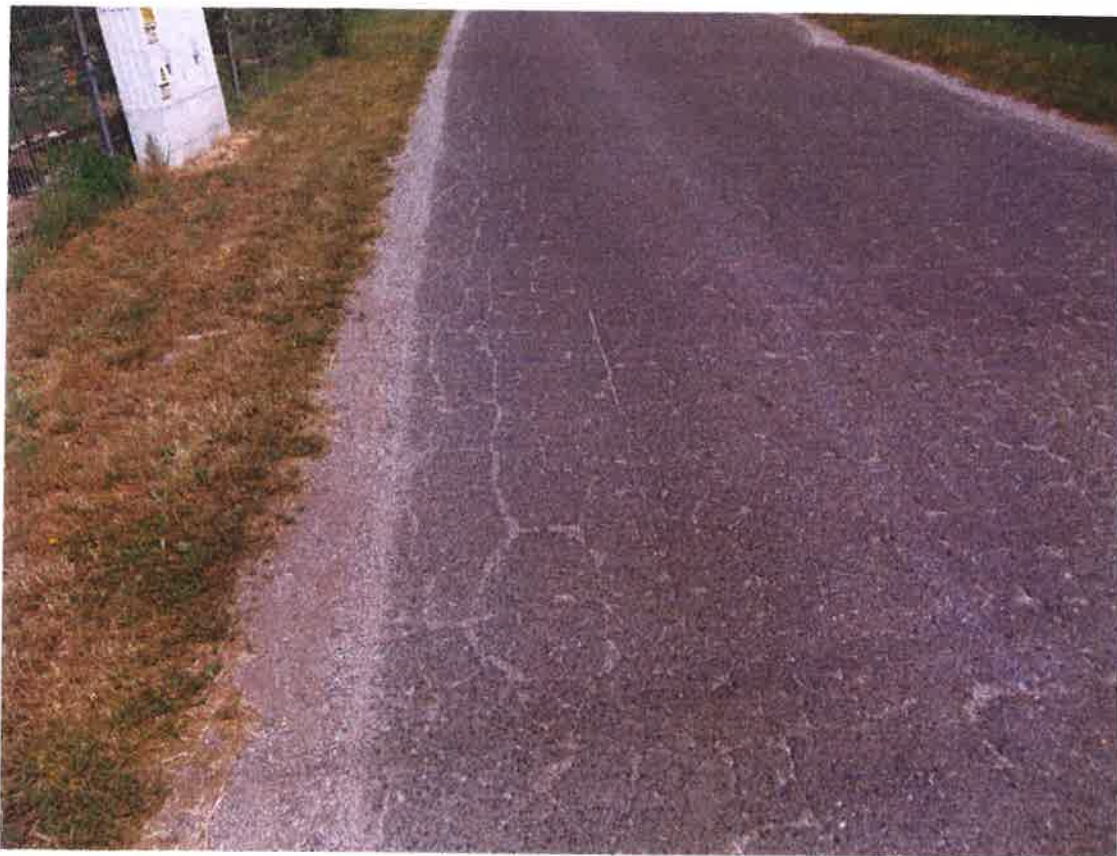
Fot . 4. Spękania nawierzchni w śladach kół ( Mrozów – Wojnowice )
