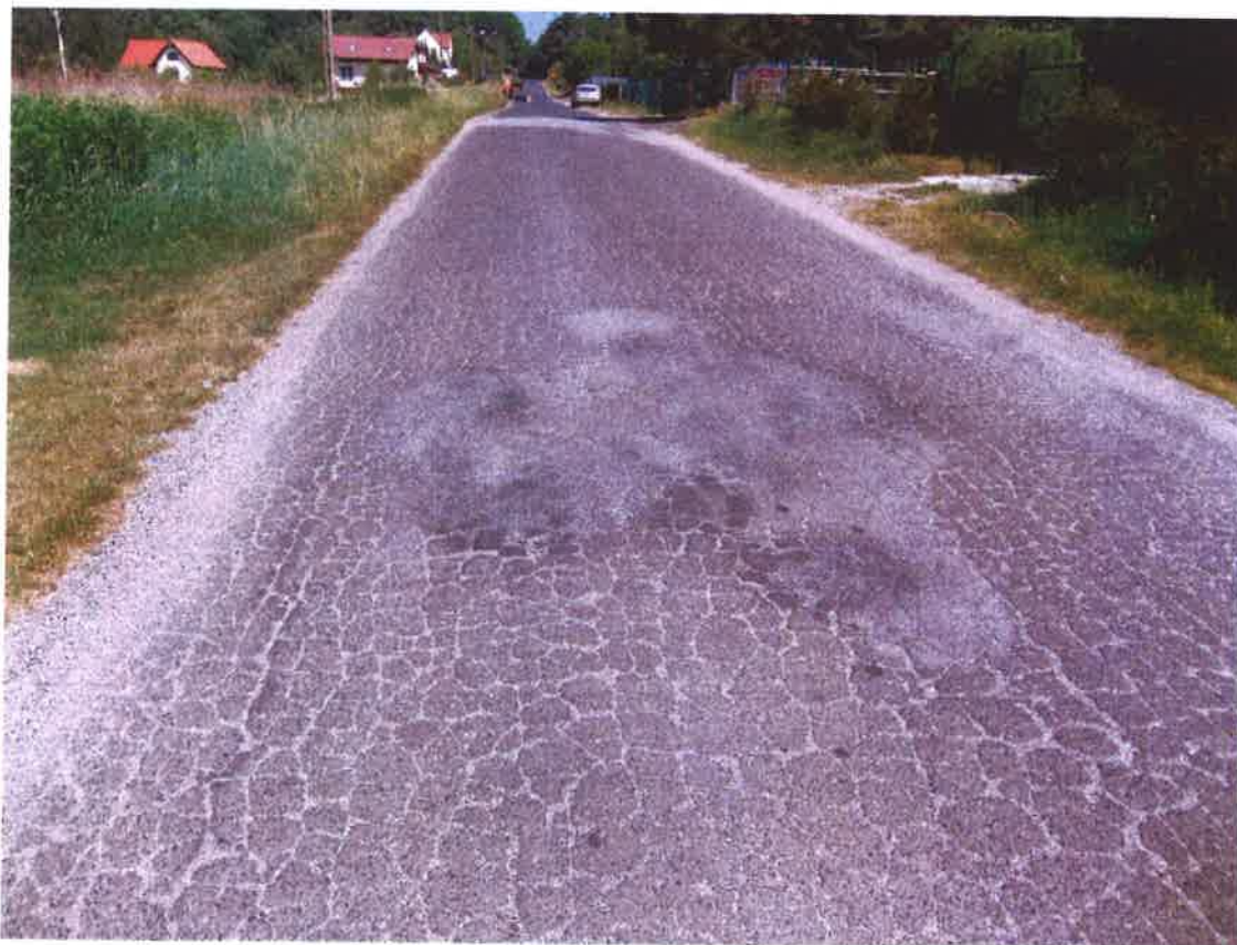
Fot . 5. Spękania i lokalne naprawy nawierzchni drogi Mrozów – Wojnowice
