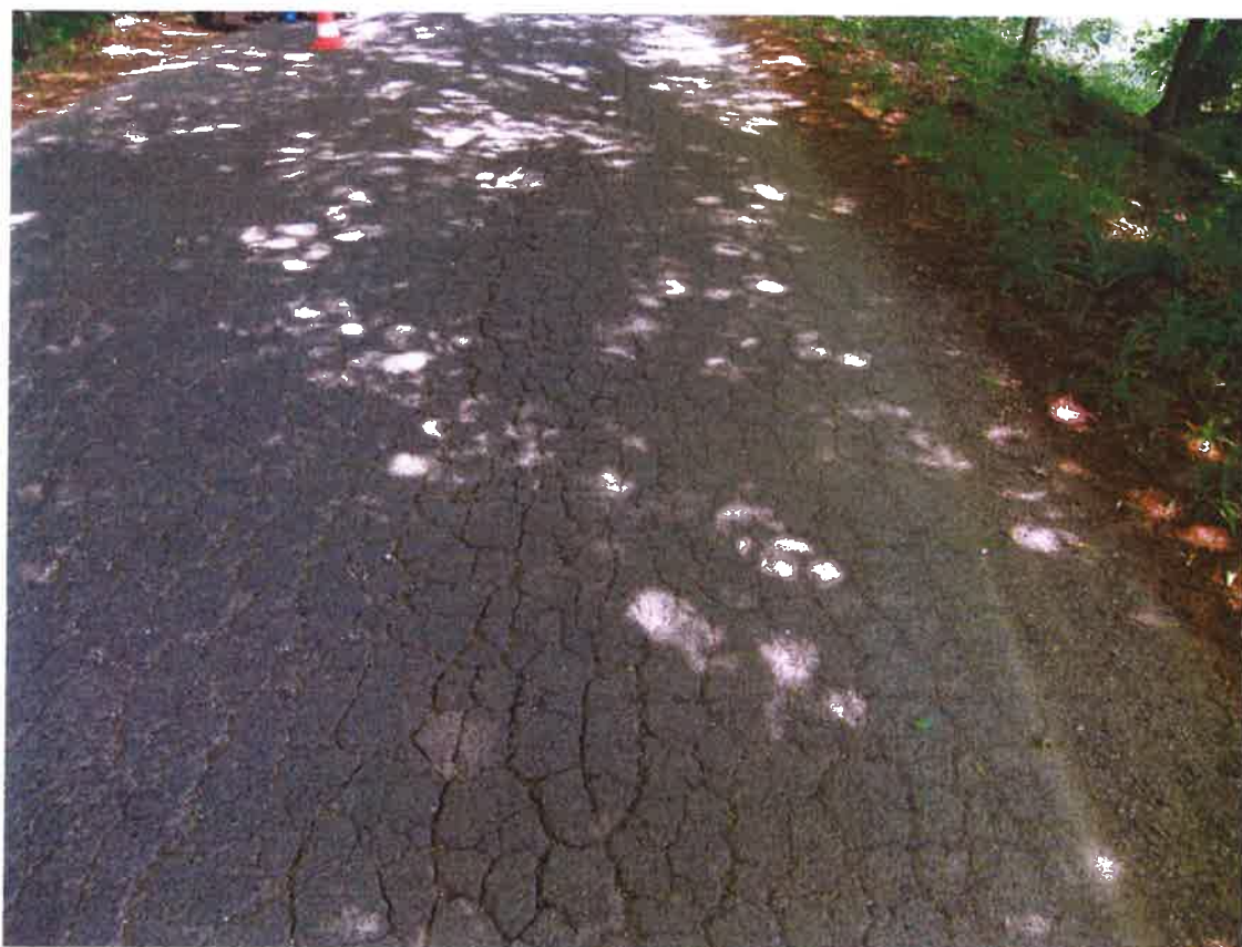
Fot. 9. Spękania nawierzchni drogi w śladach kół pojazdów
